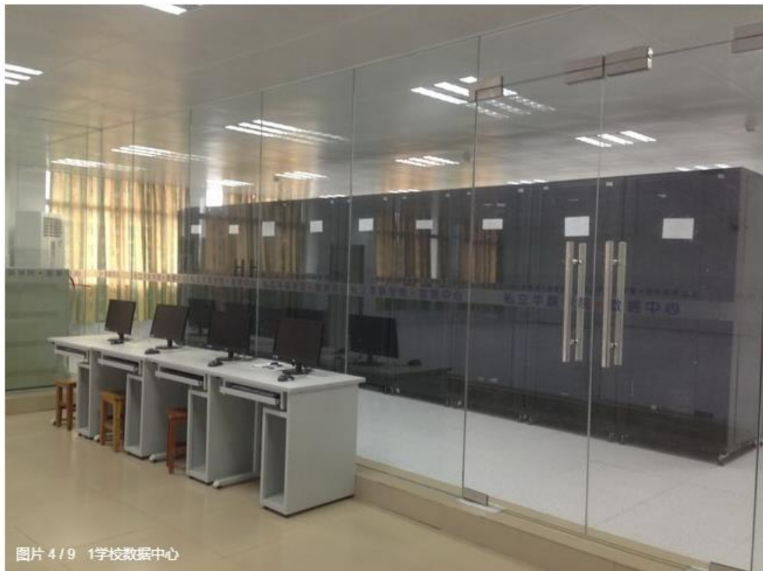
学校数据中心服务群
